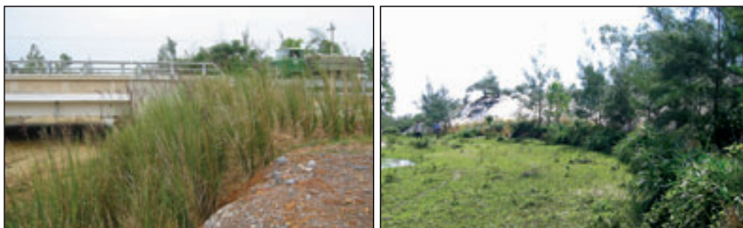
Foto 6: Esquerda: Plantas de Vetiver protegendo os pilares da ponte junto a Estrada Nacional nº. 1; direita: Dezembro de 2004, as espécies locais substituíram as plantas vetiver.
