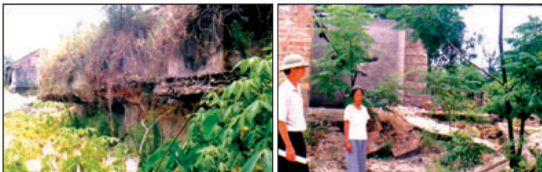
Foto 2: Fluxos de areia em Le Thuy (Quang Binh) em 1999: a fundação de uma estação de bombeamento (esquerda) e a fundação da casa de três quarto desta mulher foi danificada pelo movimento da areia (à direita).
